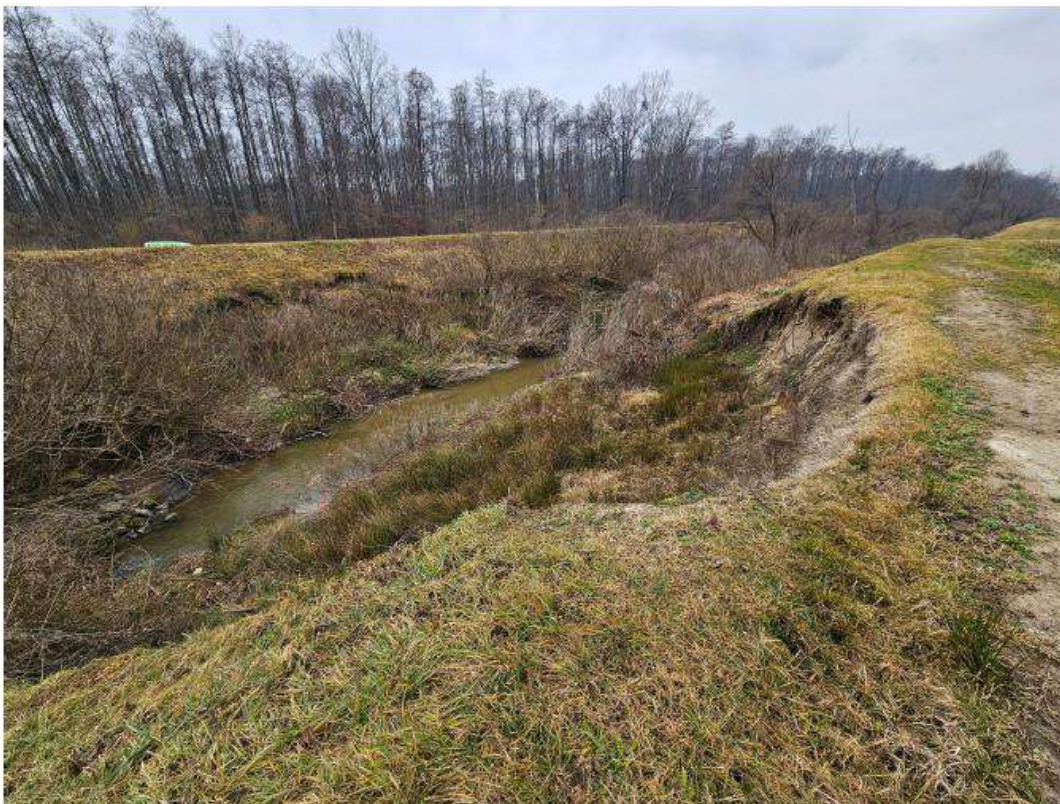
Slika 1.5 Prikaz odrona pokosa vodotoka Grabovnica
