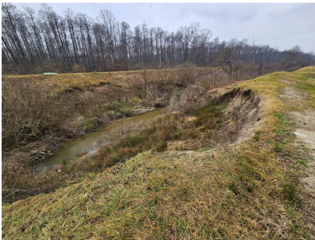
Slika 1.5 Prikaz odrona pokosa vodotoka Grabovnica
